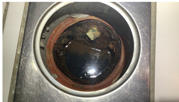
Støpejernsluk ved badekar uten klemring, og det ser ut til at opprinnelig vinylbelegg er brukt som tettesjikt.
