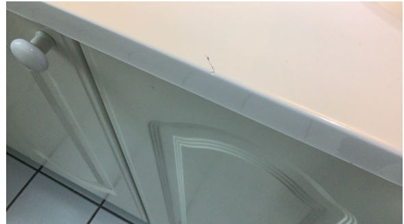
Hakk i servantbenk.
