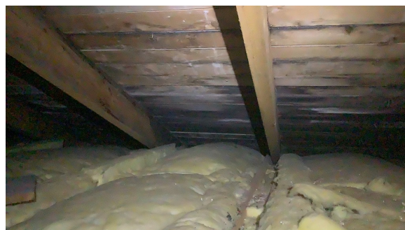
Misfarget taktro over badet.
