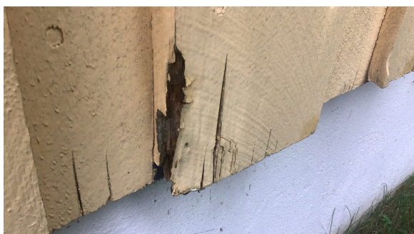
Eksempel på råteskadet kledningsbord.
