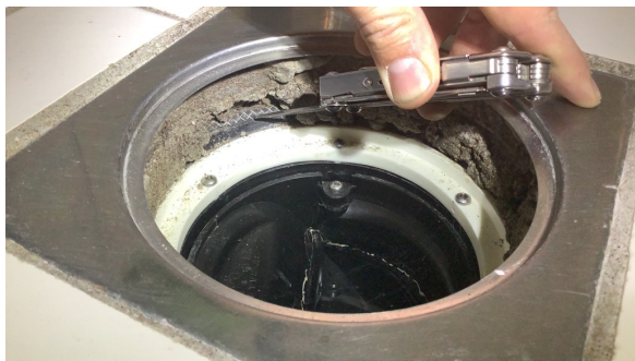
Det ser ut til at banemembran ikke er ført under slukets klemring.
