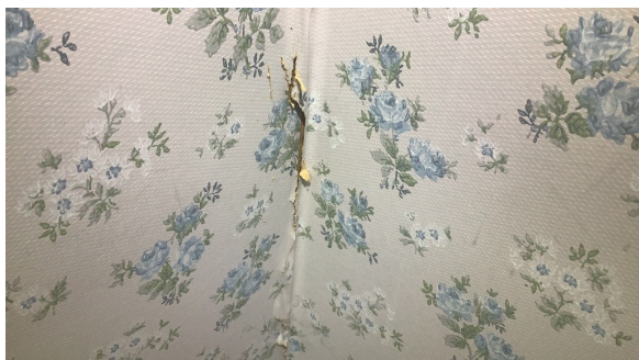
Eksempel på revnet tapet.
