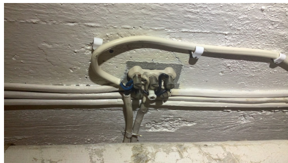
Manglende deksel på koblingsboks.
