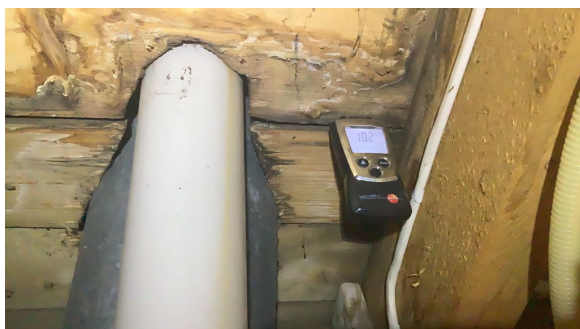
Misfarget taktro inntil luftehatt, og det måles tørt.
