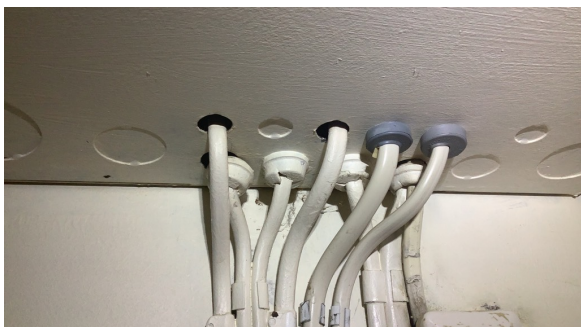
Utettet innføring i sikringsskap.
