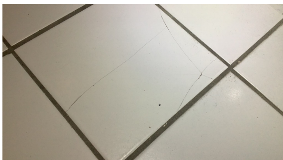
Eksempel på sprukket gulvflis.
