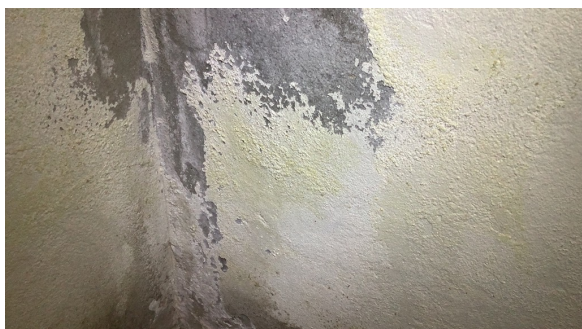
Eksempel på saltutslag på åpen murvegg.
