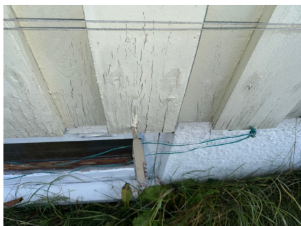
Oppsprukket kledning med råte, avskallinger og slitasje
