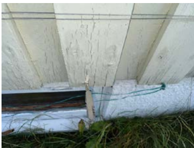
Oppsprukket kledning med råte, avskallinger og slitasje
