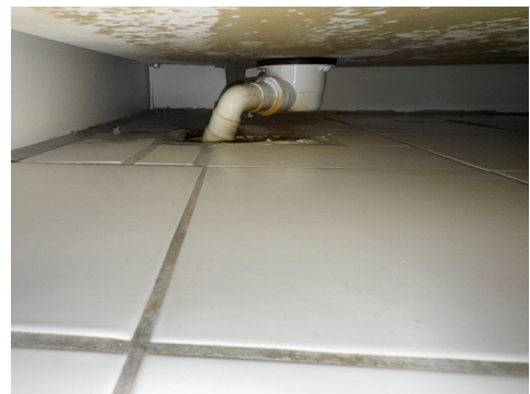
Sluk under dusjkabinett
