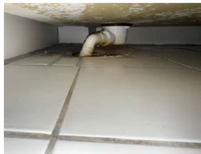
Sluk under dusjkabinett
