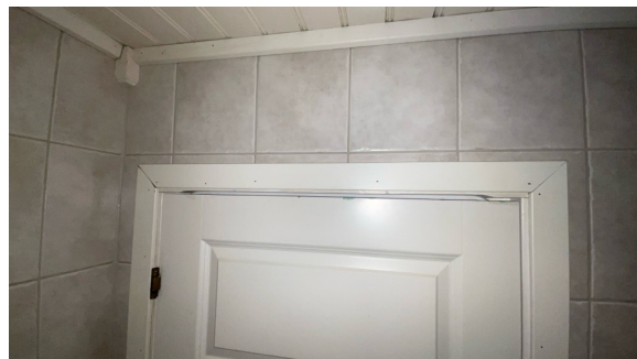
Tilluftsspalte over dør
