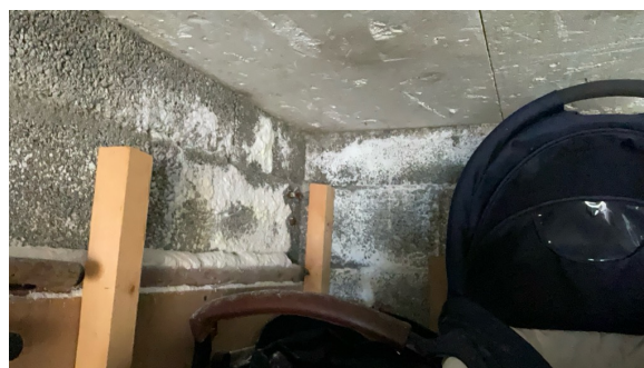
Synlig saltutslag på bakre hjørne av vegg
