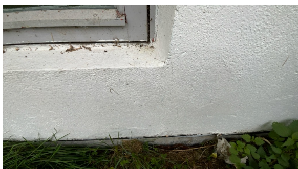
Liten sprekk i mur/puss ved kjellervindu
