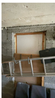
Synlig styropor i eldre døråpning mot garderobe
