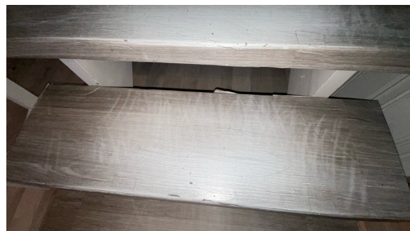
Noe slitasje på overflater i trapp
