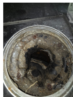
Sluk fra byggeår uten synlig tettesjikt
