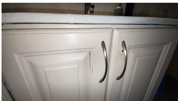
Slitasje på enkelte fronter
