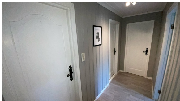
Dører til toalett, vaskerom og soverom. Dør til vaskerom er vanskelig å lukke siden dørbildet er vridt
