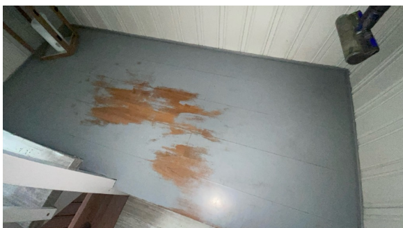
Noe slitasje på overflater i trapp
