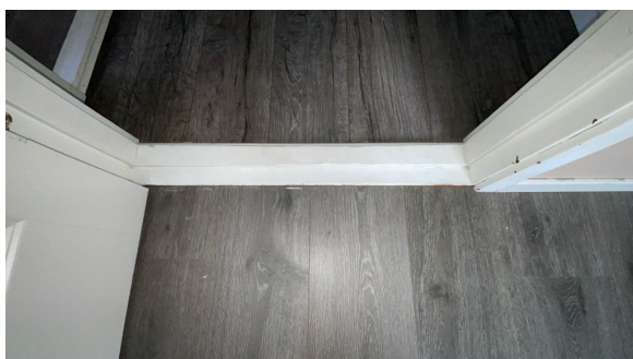
Mangler list/fuge mellom gulv og dørterskel på soverom 2 i 1. etasje
