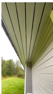
Synlig luftespalter i raftekaske ved overgang tak/vegg
