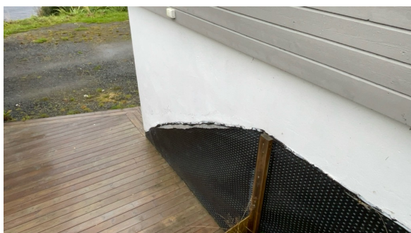
Grunnmursplast er løs ved terrasse
