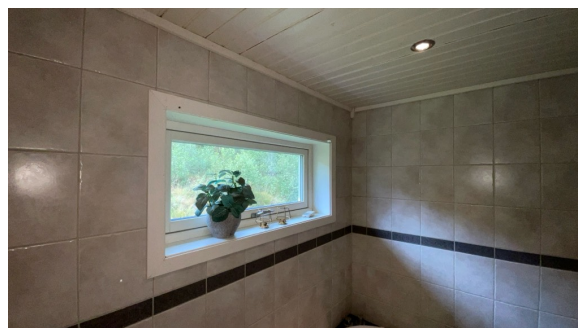
Vindu er plassert i våtzone ovenfor badekaret
