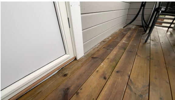
Mangler beslag mellom balkong og vegg
