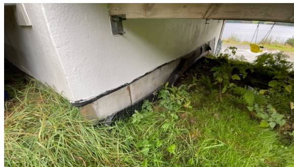
Grunnmursplast er løs ved garasje
