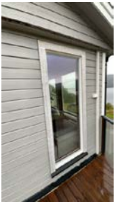
Vindu fra 2020 i overbygd hagestue mangler vannbrett over vindu og dekkbord er ikke malt
