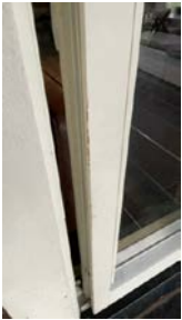
Noe overflateslitasje på skyvedør mellom stue og overbygd veranda
