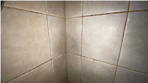
Misfarging på veggfuger i dusj
