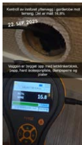
Kontroll av bunnsvill i innforet yttervegg mot terreng i garderobe. Det er målt 16,8%. Veggene er bygget opp med lettklinkerblokk, papp, hard isolasjonsplate, dampspærre og plater.
