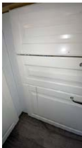
Overflateslitasje på fronter under vask
