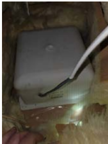
Ikke faglært utførelse ved spottkasser som ligger løst uten tilstrekkelig tetting av kabel innganger. Faglært elektriker må kontrollere dette
