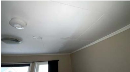
Ujevn overflate/farge i himling på soverom 1 i 1. etasje.
