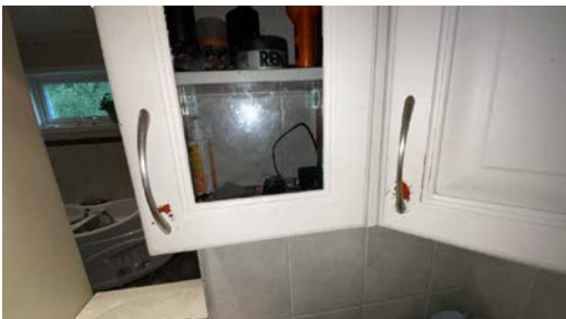
Slitasje på enkelte fronter
