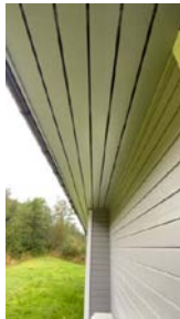
Synlig luftespalter i raftekaske ved overgang tak/vegg
