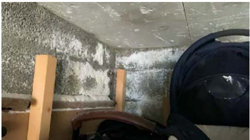
Synlig saltutslag på bakre hjørne av vegg
