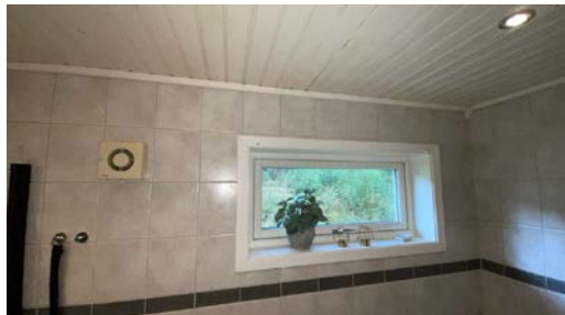
Mekanisk avtrekk på vegg og åpningsvindu
