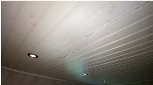
Synlig misfarging i himling som følge av kvistutslag
