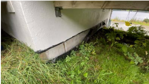
Grunnmursplast er løs ved garasje
