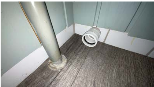
Rør som kommer fra teknisk rom er ført ut mot toalettrom
