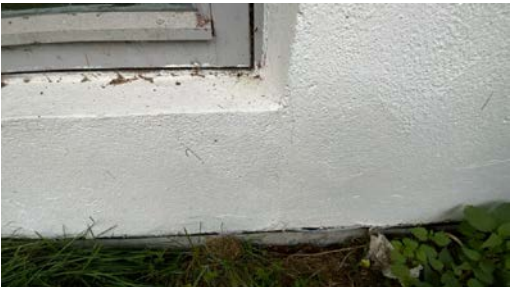
Liten sprekk i mur/puss ved kjellervindu
