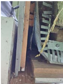
Musebånd er ikke montert riktig og det er risiko for at mus kan komme inn bak kledning. Vindsperre må også kontrolleres mot musebånd enkelte steder siden det hindrer tilstrekkelig ventilering.
