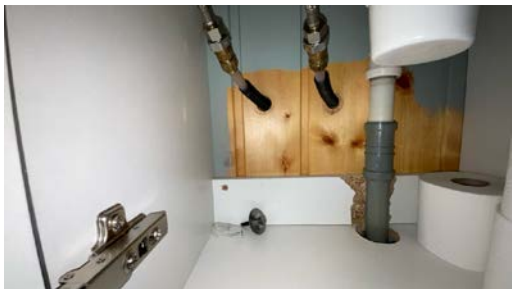
Mangler tettemuffer på ender av rør
