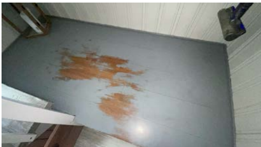
Noe slitasje på overflater i trapp
