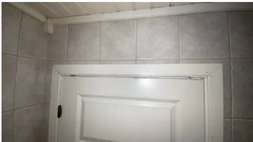
Tilluftsspalte over dør
