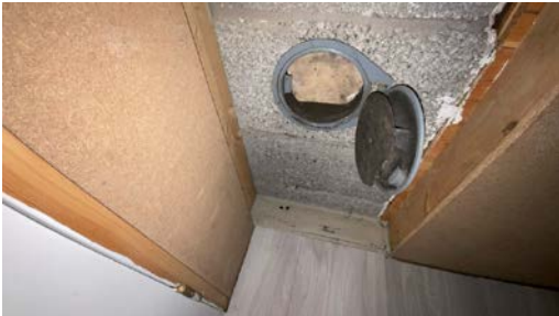
Det er montert sotlukestein i sotluke for å ivareta brann sikkerheten. Det bør monteres plate på gulv
