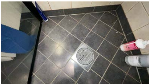
Noe slitte fuger i dusj
