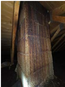
Det er misfarging på pipeløp som er synlig på kryploftet og det er misfarging på isolasjon.
