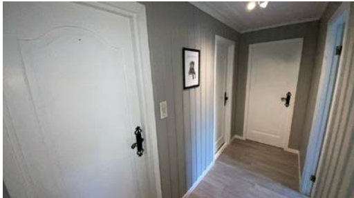
Dører til toalett, vaskerom og soverom. Dør til vaskerom er vanskelig å lukke siden dørbildet er vridd
