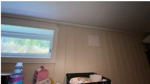
Ventil på vegg i underetasje
