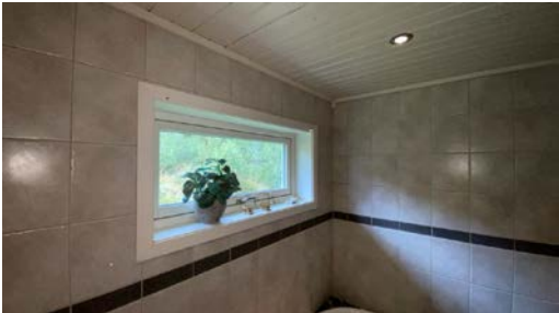
Vindu er plassert i våtzone ovenfor badekaret
