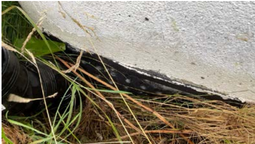
Grunnmursplast er løs ved taknedløp på hjørnet og ligger noe under terrengnivå
