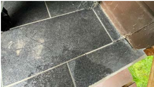
Bom i flis (Løse flis) Riss/sprekker i flisfuger ut mot trapp
