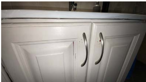
Slitasje på enkelte fronter
