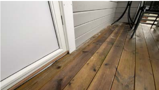
Mangler beslag mellom balkong og vegg
