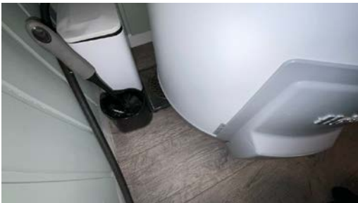
Sluk er plasert bak varmtvannstank uten synlig membran i sluk.
