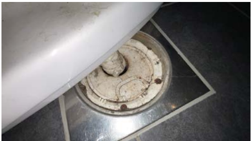
Ingen mulighet for kontroll i sluk ved badekar, tettet med fugemasse.
