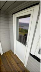
Balkongdør med utgang fra soverom. Mangler beslag under døra
