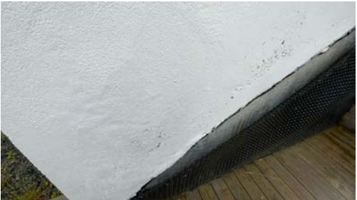
Avskalling i malingsoverflate på muren ved terrasse
