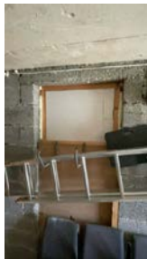
Synlig styropor i eldre døråpning mot garderobe
