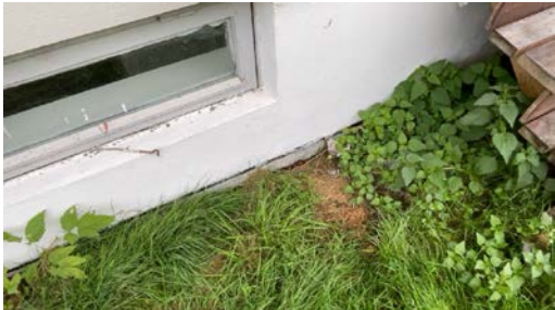
Grunnmursplast er løs ved kjellervindu
