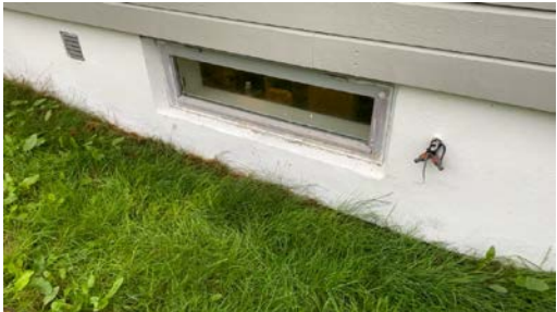
Vindu på vaskerom
