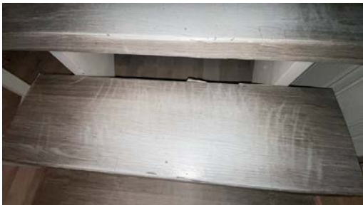
Noe slitasje på overflater i trapp
