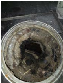
Sluk fra byggeår uten synlig tettesjikt
