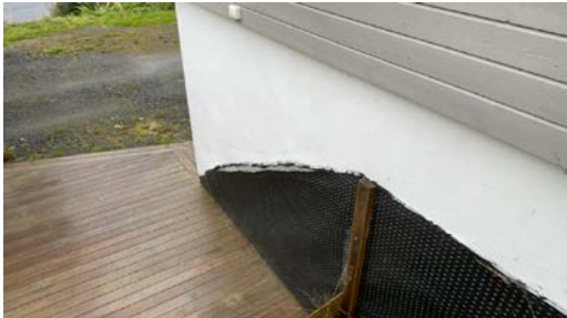
Grunnmursplast er løs ved terrasse
