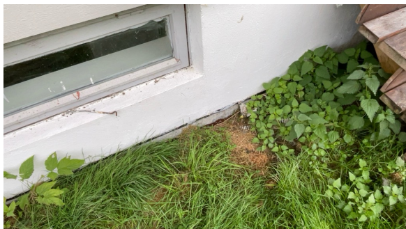
Grunnmursplast er løs ved kjellervindu
