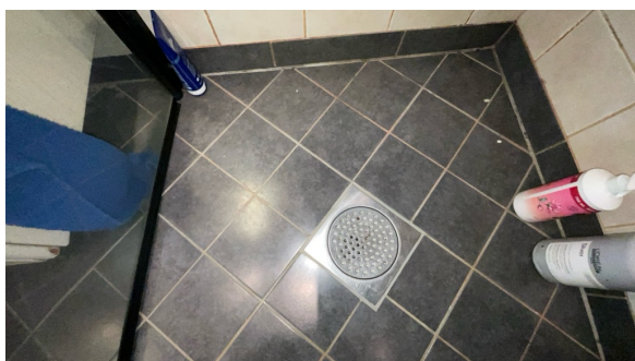
Noe slitte fuger i dusj
