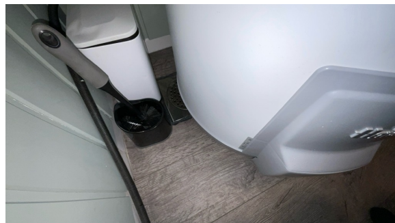
Sluk er plassert bak varmtvannstank uten synlig membran i sluk.
