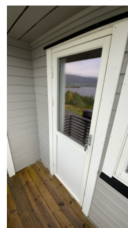
Balkongdør med utgang fra soverom. Mangler beslag under døra
