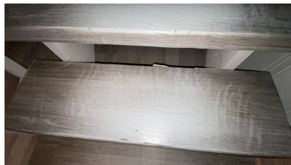
Noe slitasje på overflater i trapp
