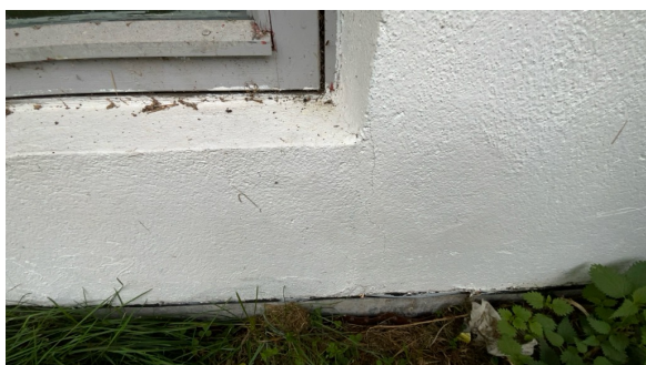
Liten sprekk i mur/puss ved kjellervindu
