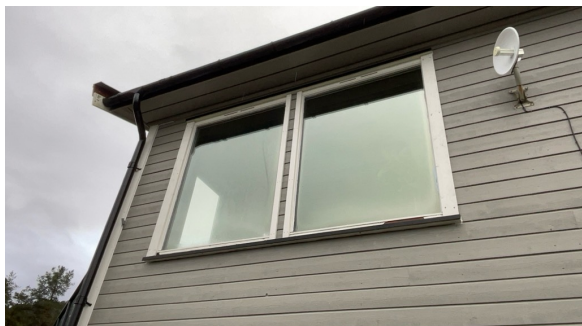
Vindu i overbygd veranda, punkterte glass
