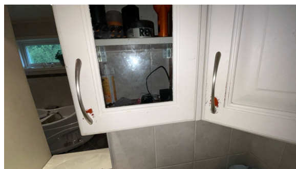
Slitasje på enkelte fronter
