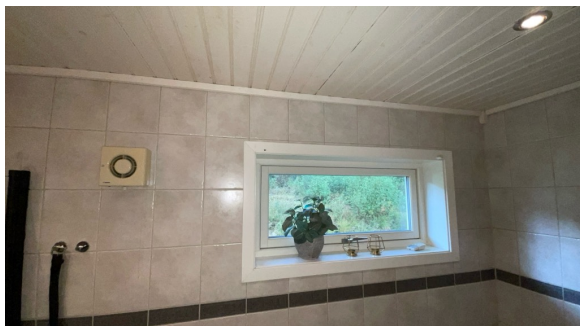
Mekanisk avtrekk på vegg og åpningsvindu
