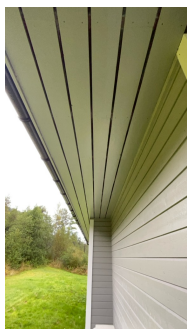
Synlig luftespalter i raftekasse ved overgang tak/vegg
