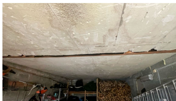
Synlig styropor i himling
