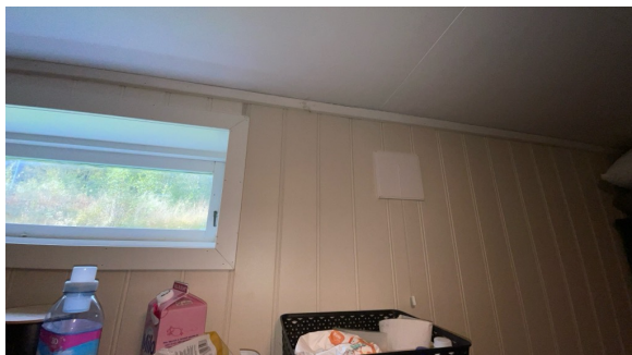
Ventil på vegg i underetasje
