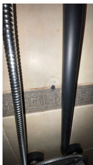
Det er ikke tettet i eldre skruehull for dusjgarnityr. Må tettes
