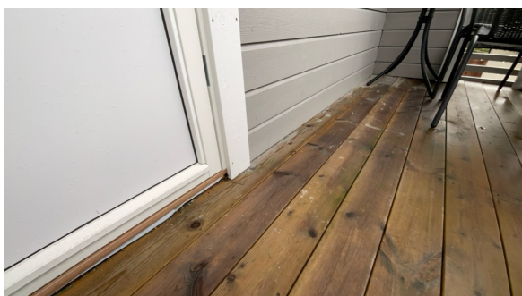
Mangler beslag mellom balkong og vegg
