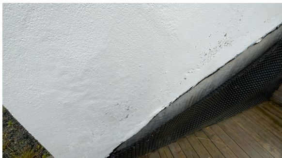
Avskalling i malingsoverflate på muren ved terrasse
