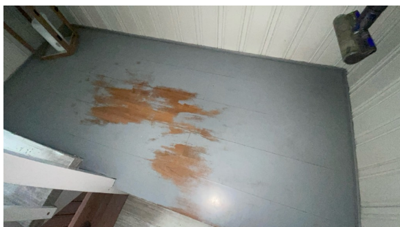
Noe slitasje på overflater i trapp
