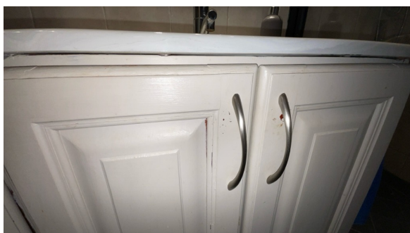
Slitasje på enkelte fronter
