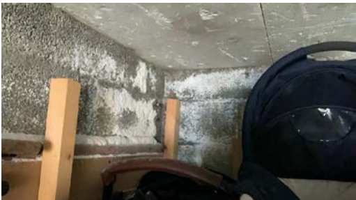
Synlig saltutslag på bakre hjørne av vegg
