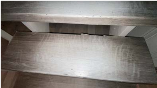
Noe slitasje på overflater i trapp
