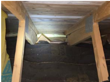
Konstruksjon er ikke tilstrekkelig luftet over kjøkken og det er synlig hvitt mugg på underpanelet enkelte steder
