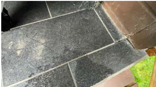
Bom i flis (Løse flis) Riss/sprekker i flisfuger ut mot trapp
