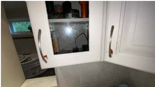
Slitasje på enkelte fronter
