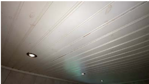
Synlig misfarging i himling som følge av kvistutslag
