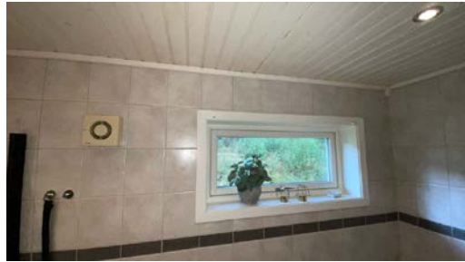
Mekanisk avtrekk på vegg og åpningsvindu
