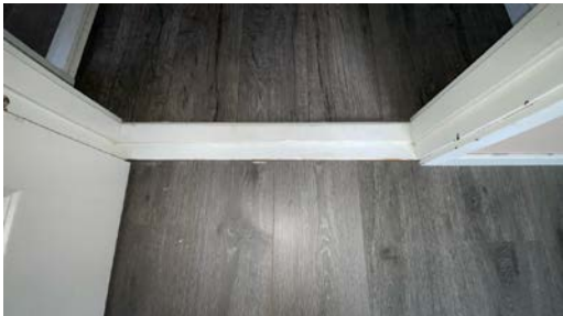
Mangler list/fuge mellom gulv og dørterskel på soverom 2 i 1. etasje
