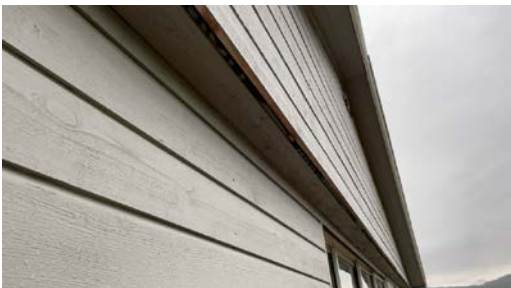
Mangler dekkbord over vindsperre på gavelvegg mot veranda.
