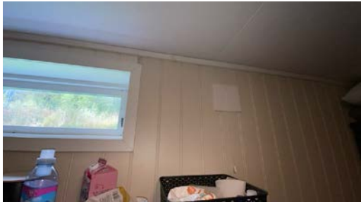
Ventil på vegg i underetasje
