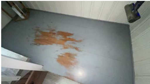
Noe slitasje på overflater i trapp
