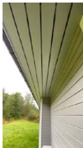
Synlig luftespalter i raftekasse ved overgang tak/vegg
