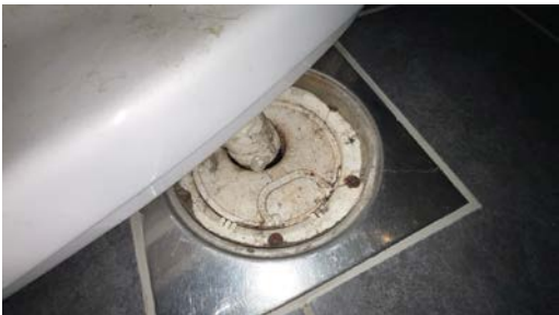
Ingen mulighet for kontroll i sluk ved badekar, tettet med fugemasse.
