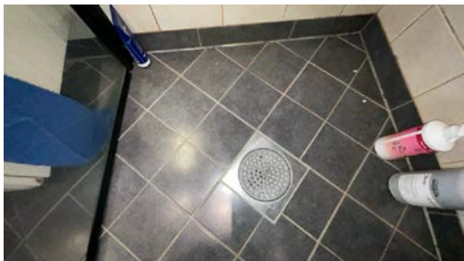
Noe slitte fuger i dusj
