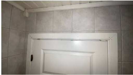
Tilluftsspalte over dør
