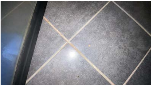
Skade på flis i dusj
