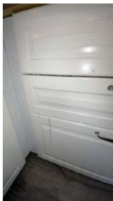
Overflateslitasje på fronter under vask
