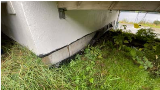
Grunnmursplast er løs ved garasje
