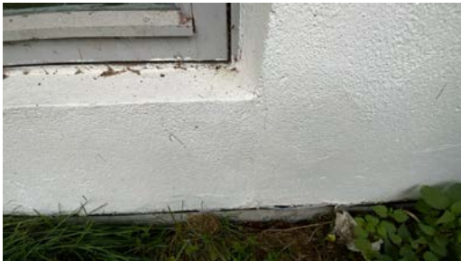
Liten sprekk i mur/puss ved kjellervindu
