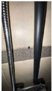
Det er ikke tettet i eldre skruerull for dusjgarnityr. Må tettes
