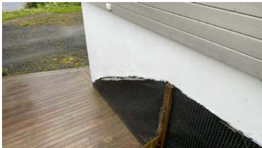
Grunnmursplast er løs ved terrasse
