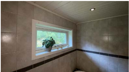
Vindu er plassert i våtzone ovenfor badekaret
