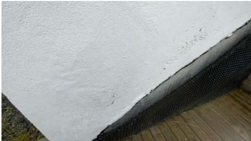
Avskalling i malingsoverflate på muren ved terrasse
