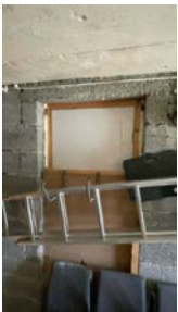
Synlig styropor i eldre døråpning mot garderobe
