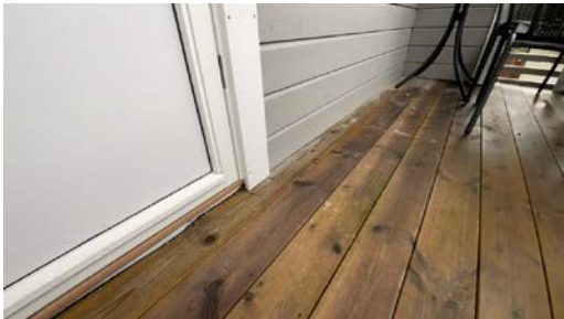
Mangler beslag mellom balkong og vegg
