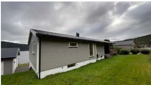
Oversikt. Det er ikke montert snøfangere på taktekingen
