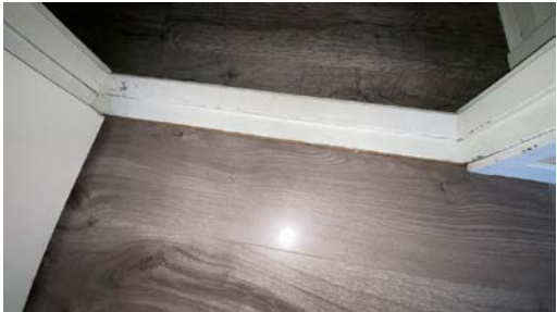
Mangler list/fuge mellom gulv og dørterskel på soverom 1 i 1. etasje
