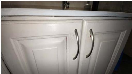
Slitasje på enkelte fronter
