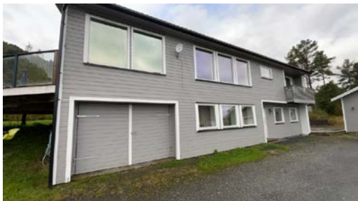
Oversikt. Bordkledning går stedvis nesten helt ned i terreng.
