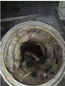
Sluk fra byggeår uten synlig tettesjikt
