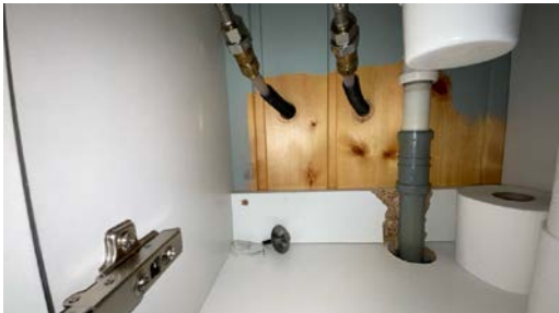
Mangler tettemuffer på ender av rør
