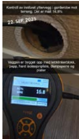
Kontroll av bunnsvill i innforet yttervegg mot terreng i garderobe. Det er målt 16,8%. Veggene er bygget opp med lettklinkerblokk, papp, hard isolasjonsplate, dampsperre og plater.
