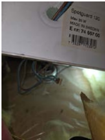
Kasser ved spotter er ikke tette og det er fare for kondens opp til kryploftet
