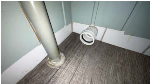
Rør som kommer fra teknisk rom er ført ut mot toalettrom
