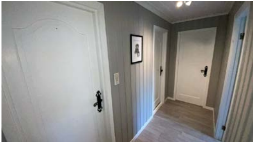
Dører til toalett, vaskerom og soverom. Dør til vaskerom er vanskelig å lukke siden dørbladet er vridd
