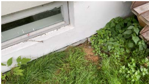
Grunnmursplast er løs ved kjellervindu
