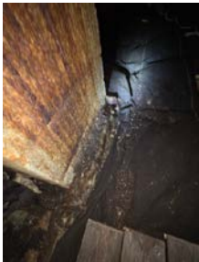
Det er misfarging på pipeløp som er synlig på kryploftet og det er misfarging på isolasjon.
