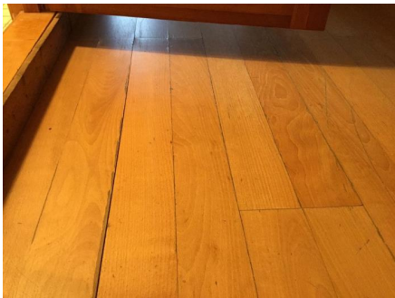
Mindre fuktskader på parkett utenfor våtrom.
