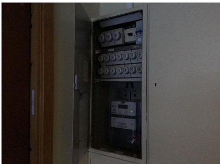
Sikringsskap plassert i felles oppgang.
