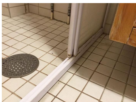
Dusjhjørne i dårlig stand.
