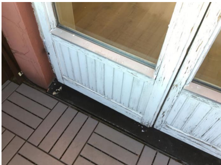
Slitasje på balkongdør.
