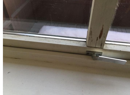
Kondensmerker på vindu enkelte steder.
