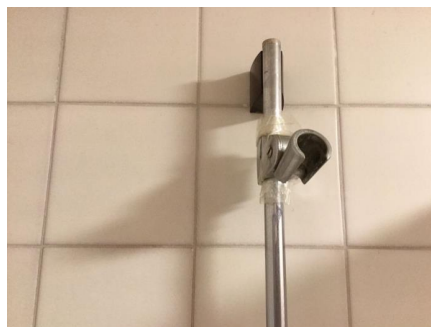
Oppheng til dusj i dårlig stand.
