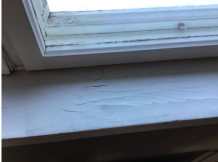
Sprekker på vinduskarm.
