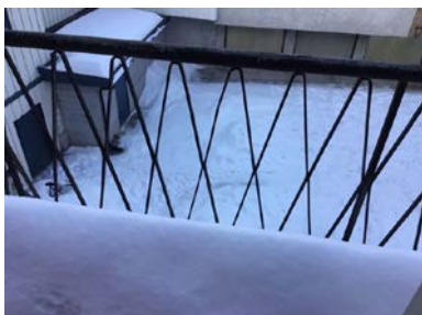
Leiligheten har tilgang til felles balkong mot nord. Her er åpninger i rekkverk større enn hva som er anbefalt etter dagens forskrift.
