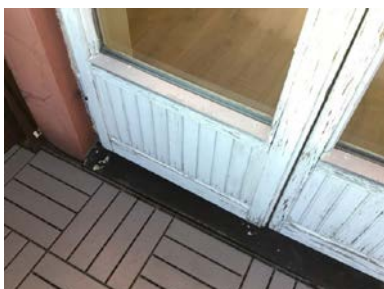
Slitasje på balkongdør.
