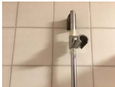
Oppheng til dusj i dårlig stand.
