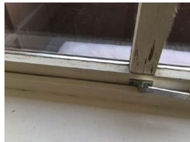
Kondensmerker på vindu enkelte steder.
