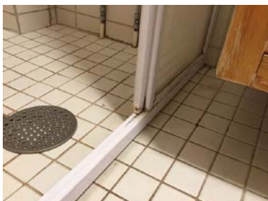
Dusjhjørne i dårlig stand.
