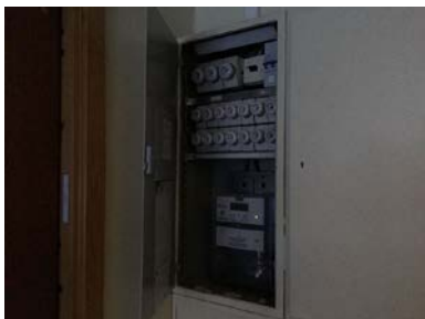
Sikringsskap plassert i felles oppgang.
