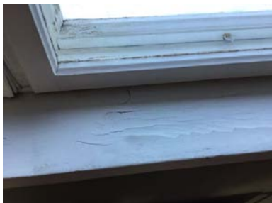
Sprekker på vinduskarm.
