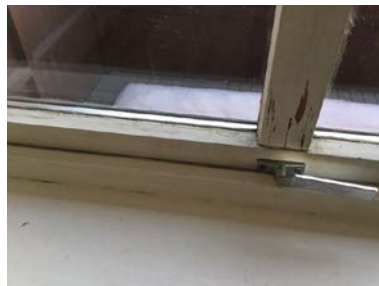
Kondensmerker på vindu enkelte steder.
