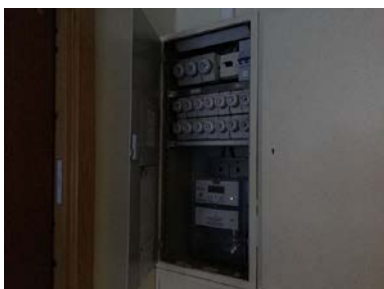
Sikringsskap plassert i felles oppgang.
