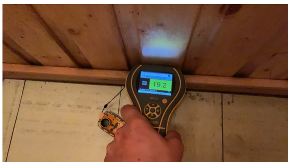
Piggmåling i veggpanel viser over 19 %.
