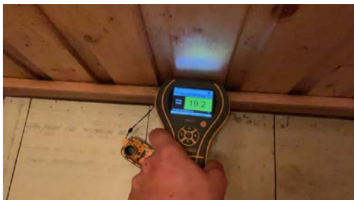
Piggmåling i veggpanel viser over 19 %.
