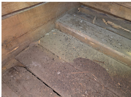
Mye muselort på kaldtloft bak knevegger
