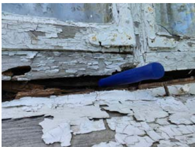
Råteskade både på vindu, og i konstruksjon under vinduet.
