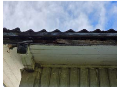
Store råteskader i pannebord og potensielt videre inn
