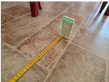
Ca. 34mm høydeforskjell innenfor 2 meter på soverom i 2. etasje
