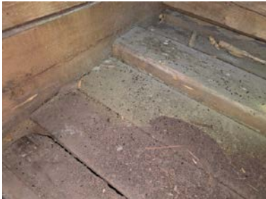
Mye muselort på kaldtloft bak knevegger
