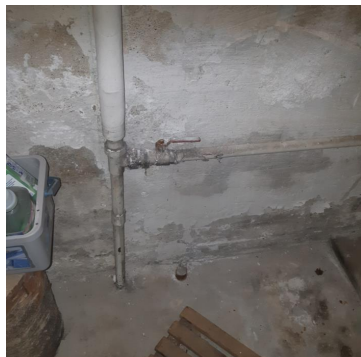
Stoppekran i vaskekjeller
