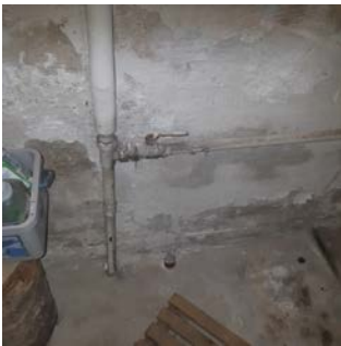
Stoppekran i vaskekjeller
