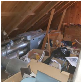
Flebu Villavent Ventilasjonsanlegg -1995
