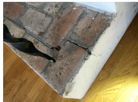
Sprekker i åpen peis.
