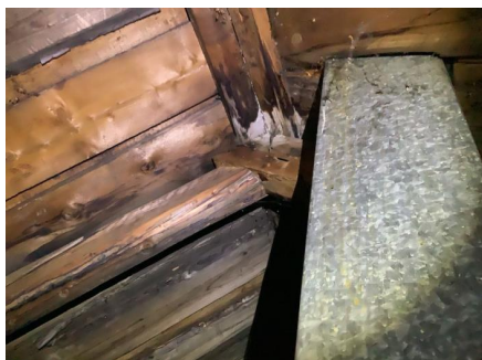
Fuktmerker rundt gjennomføringer.
