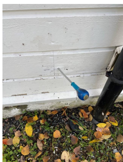
Kledning har spredte råteskader.
