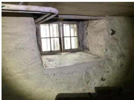
Tykkelsen på steinmuren gjør at det kan være usynlige råteskader i bunnsvill over mur.
