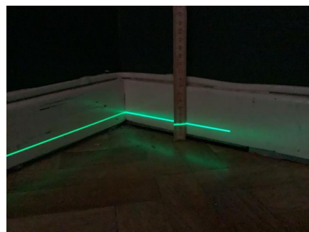
15 mm høydeforskjell i gulv soverom 2. etg.
