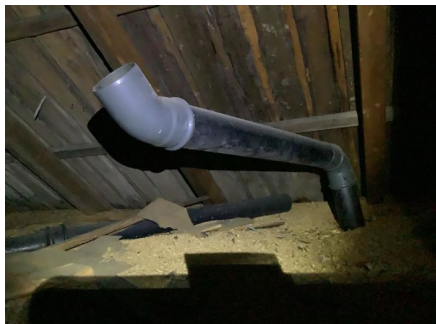
Lufterør, eller rør fra ventilasjon bad, er ikke ført gjennom takteking.
