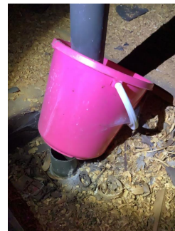
Lufting fra kloakk er brutt og det er plassert en bøtte under. Tyder på at det har vært kondens fra lufterøret.
