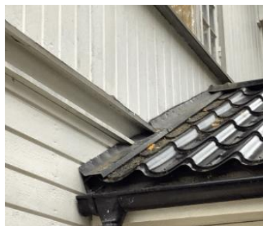
Veggbeslag mot takteking er ikke fagmessig utført.
