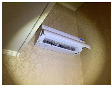
Luft-luft varmepumpe er plassert i trapp.
