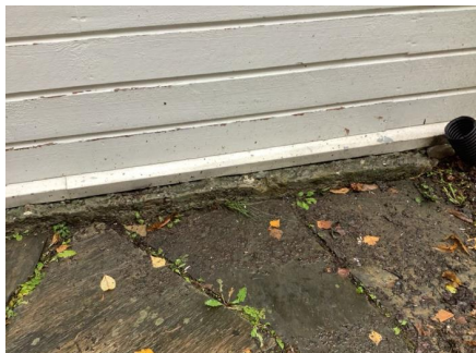
Kledningen ligger uten avstand til terreng.
