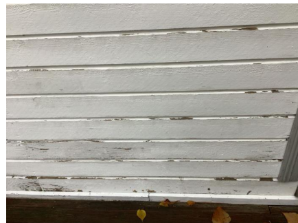
Behov for vedlikehold og utskiftinger.
