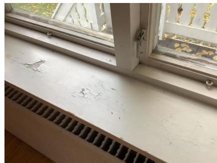
Det er kondensmerker innvendig og mellom glassrammer.
