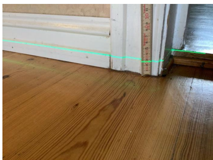
15 mm høydeforskjell i gulv stue 1. etg.
