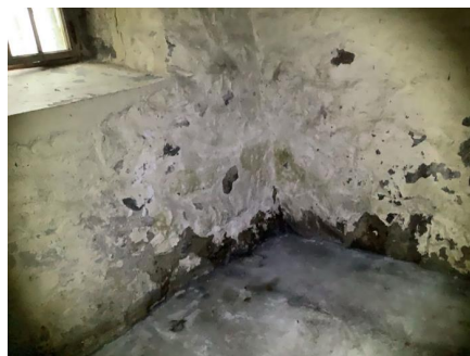
Fuktgjennomslag er registrert
