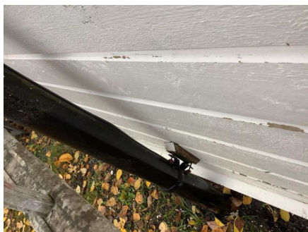
Nedløpsrør er frostsprengt.
