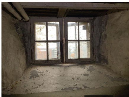
Kjellervinduer er værslitt.
