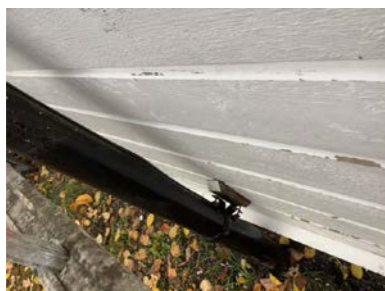
Nedløpsrør er frostsprengt.
