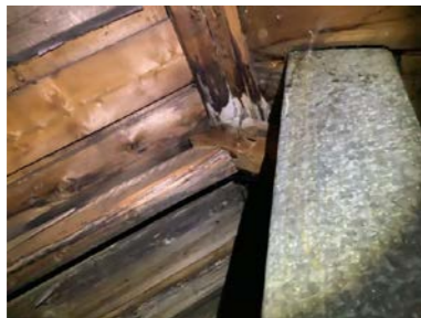
Fuktmerker rundt gjennomføringer.
