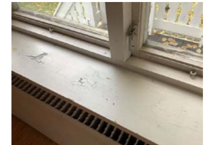
Det er kondensmerker innvendig og mellom glassrammer.
