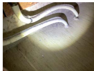
Utett rørgjennomføring i gulv.
