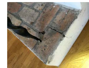
Sprekker i åpen peis.
