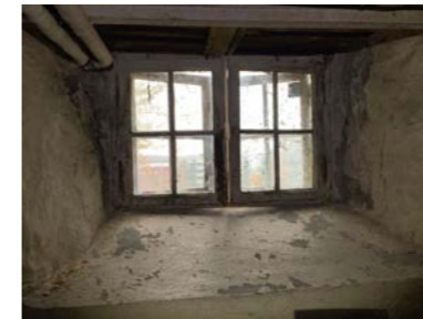
Kjellervinduer er værslitt.
