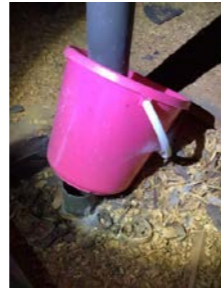
Lufting fra kloakk er brutt og det er plassert en bøtte under. Tyder på at det har vært kondens fra lufterøret.
