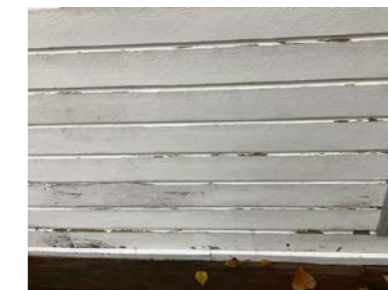
Behov for vedlikehold og utskiftings.
