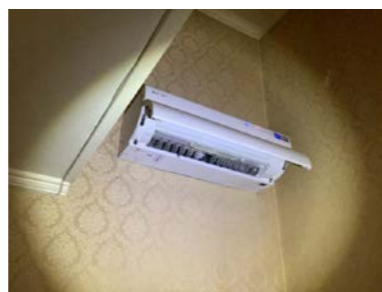
Luft-luft varmepumpe er plassert i trapp.
