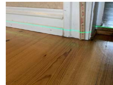
15 mm høydeforskjell i gulv stue 1. etg.
