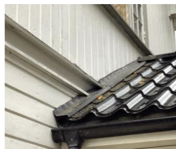
Veggbeslag mot takteking er ikke fagmessig utført.
