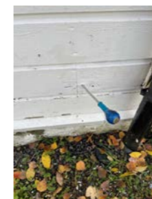
Kledning har spredte råteskader.
