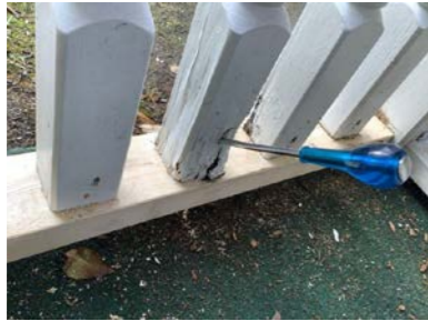
Rekkverk ved inngang har råteskader.
