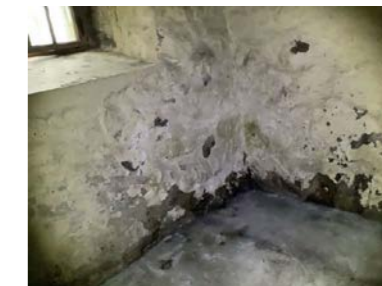
Fuktgjennomslag er registrert
