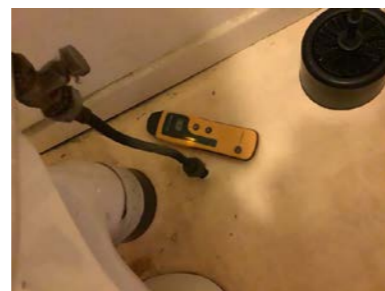
Det var indikasjoner på fukt under belegg bak toalett.
