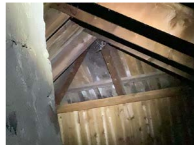
Fuktmerker på undertak. Tyder på kondens etter for dårlig gjennomlufting av kaldt loft.
