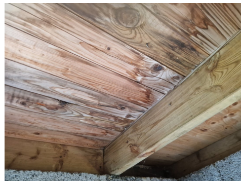
Eldre fuktmerker i himling under terrasse.
