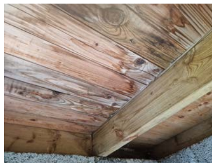
Eldre fuktmerker i himling under terrasse.
