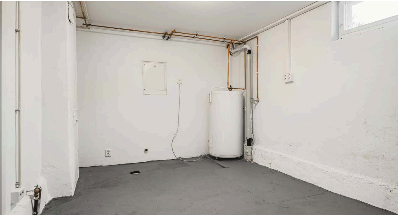
Vaskerom i kjelleren med opplegg for vaskemaskin.
