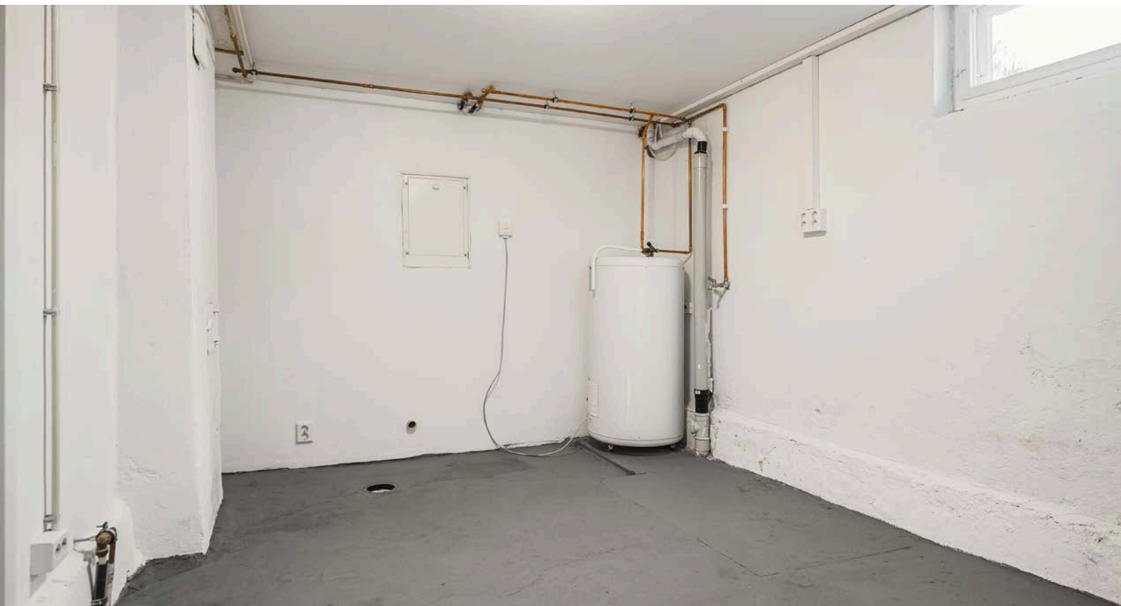
Vaskerom i kjelleren med opplegg for vaskemaskin.
