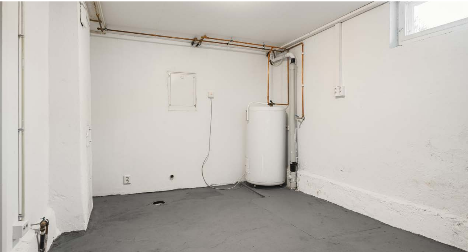
Vaskerom i kjelleren med opplegg for vaskemaskin.
