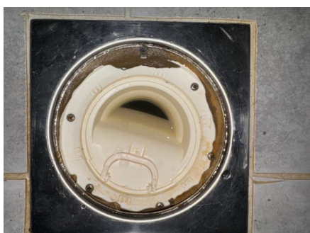
Plastsluk med klemring i dusjsone
