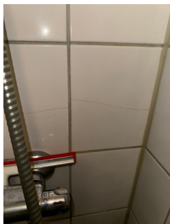
Påvist sprukne veggfliser i dusjsone
