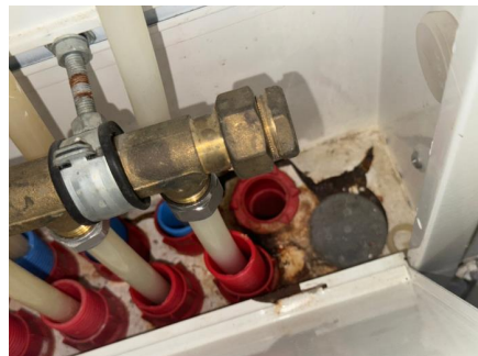
Vannfordelerskap har rustskade
