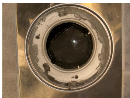
Plastsluk med klemring ved servant
