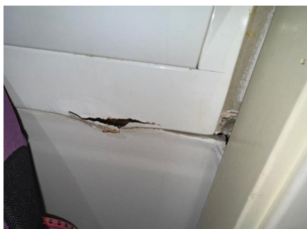
Vannfordelerskap har rustskade
