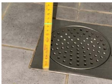
Fallforhold ca. 127 mm topp slukrist i dusjsone
