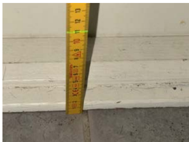
Fallforhold ca. 109 mm overkant gulv ved terskel
