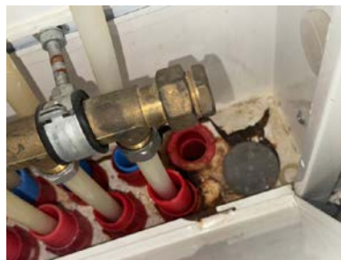
Vannfordelerskap har rustskade
