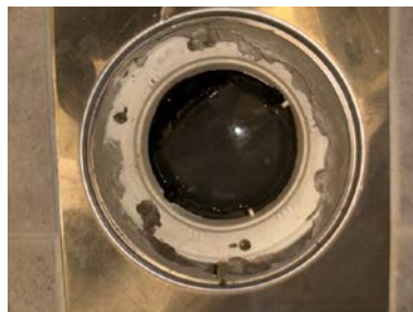
Plastsluk med klemring ved servant
