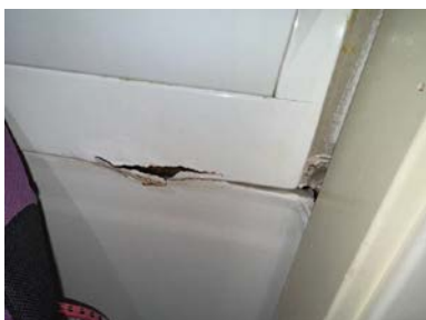
Vannfordelerskap har rustskade
