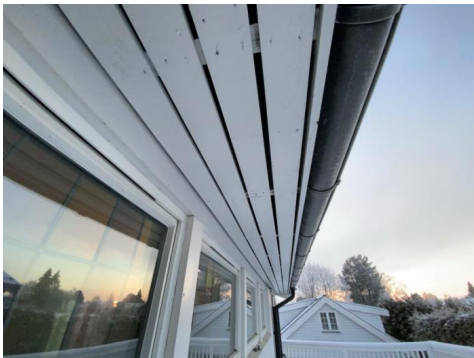
Synlige luftespalter i gesimskasse.
