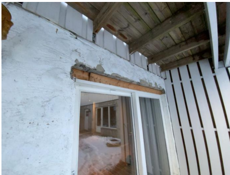
Lokale utbedringer er påregnelig.
