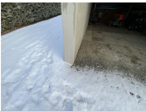
Synlige avvik på nedre del av grunnmur til carport.
