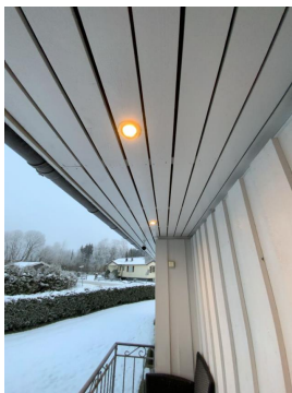
Synlige luftespalter i gesimskasse.
