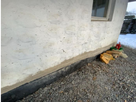
Lokale utbedringer er påregnelig.
