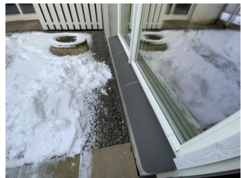
Stedvis behov for utbedringer av vindusblikk.
