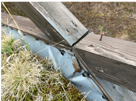
Bildet viser mangelfull utførelse på isbord og spir med fare for inntregning av fukt.
