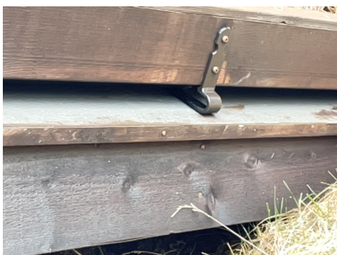
Bildet viser at det mangler forkantbeslag i overgang folietekking og taktro.
