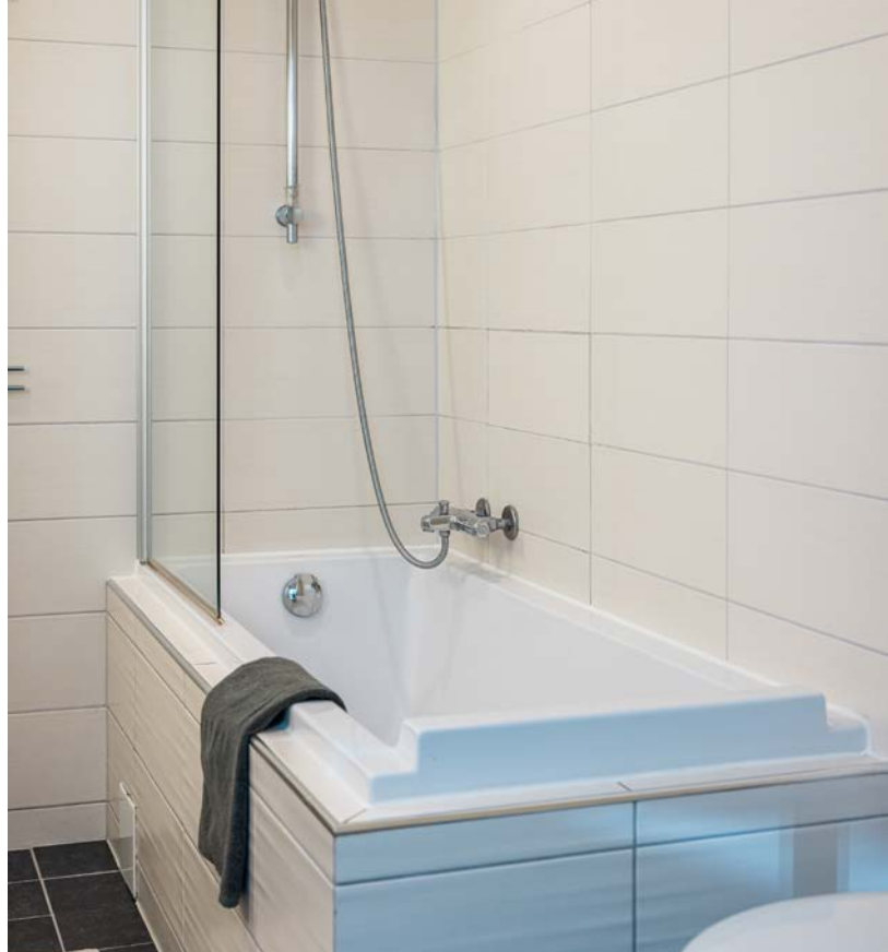
Innfliset badekar med termostatstyrt blandebatteri og halvvegg i glass.
