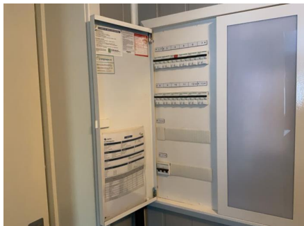
Sikringsskap plassert i gang.
