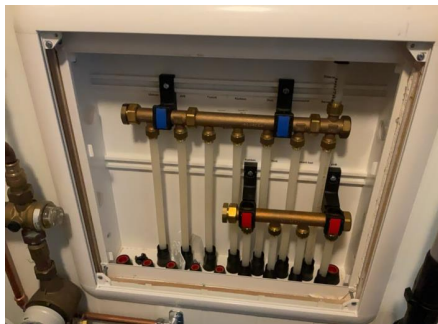
Fordelingsskap plassert på bod.
