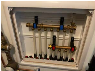
Fordelingsskap plassert på bod.
