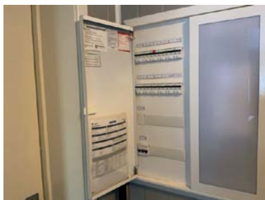
Sikringsskap plassert i gang.
