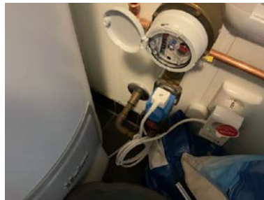
Stoppekran plassert på bod.
