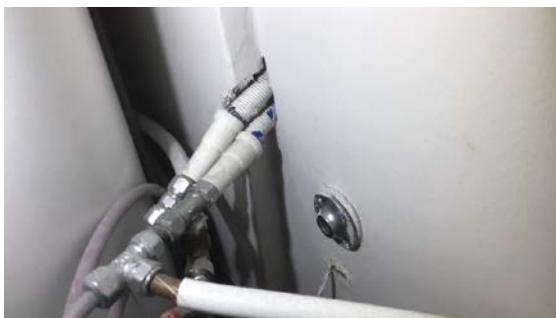
utettheter rundt rør
