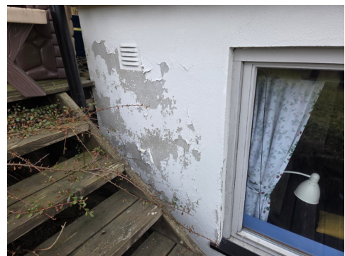
Avskaling maling grunnmur.
