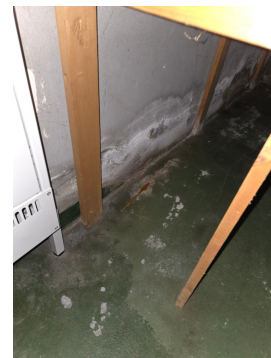
Synlig saltutslag i bod med fritt eksponert murverk
