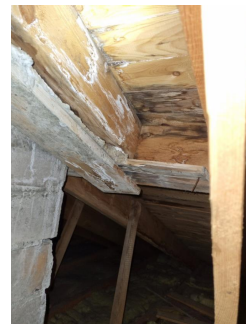
Eldre fuktmerker i takkonstruksjon ved pipe. Ingen fukt på befaringsdagen
