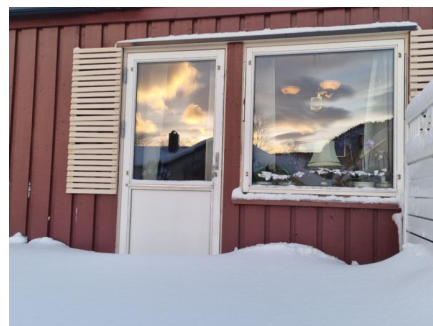
Verandadør er ikke kontrollert fra utsiden
