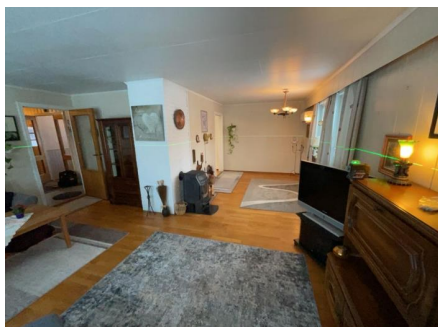
1. etasje Plassering av laser ved kontroll av stue. Det er målt 20 mm høydeforskjell gjennom rommet. TG 2. Over en avstand på 2 meter er det målt 18 mm fra hjørne ved varmpumpe mot vedovn. TG 2
