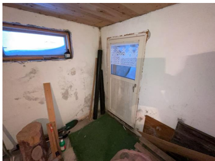
Saltutslag i lagerrom
