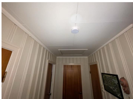
Brannmelder i gang 1. etasje
