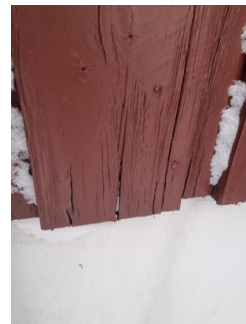
Sprekk/råte i nedre del av bord
