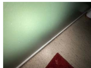
- Belegg på gulv er noe løst langs gulvlist.
