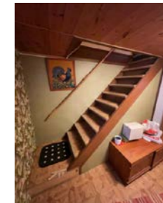
Trapp sett fra kjeller. Det mangler rekkverk
