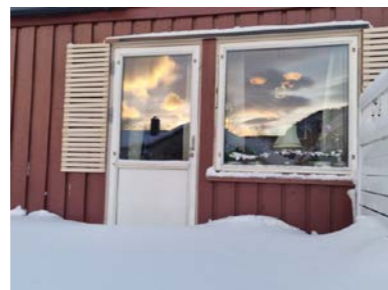
Verandadør er ikke kontrollert fra utsiden
