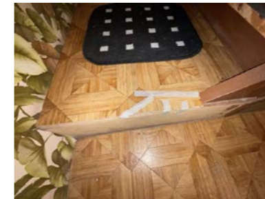
- Skade på belegg nede på repo
