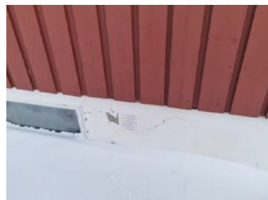
Fuktopptrekk er synlig på grunnmur
