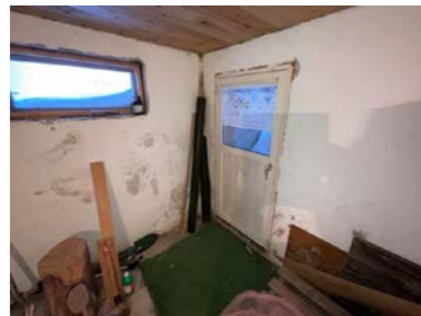
Saltutslag i lagerrom
