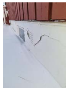
Løs puss er synlig på grunnmur mot hage
