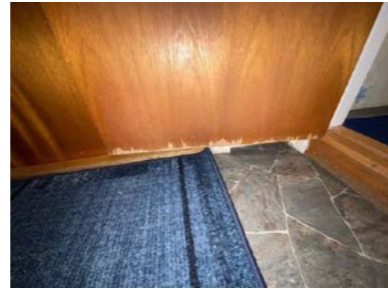
Skade på baderomsdør i nedre del mot bad.
