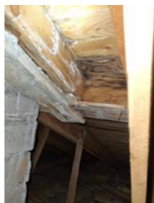
Eldre fuktmerker i takkonstruksjon ved pipe. Ingen fukt på befaringdagen
