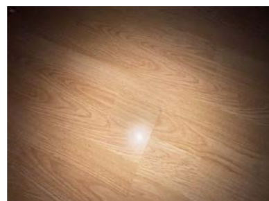
Liten skade på laminatgulv soverom 2
