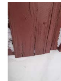
Sprekk/råte i nedre del av bord
