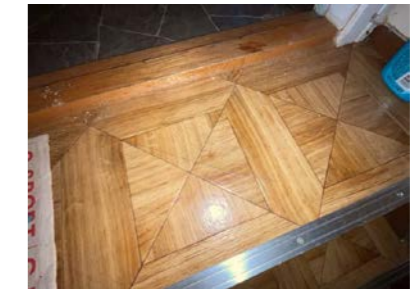
- Sprekk/riss i belegg på øverste trinn
