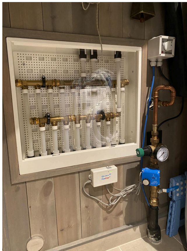
Vannfordelskap. Hovedvanninntak med stoppekran.
