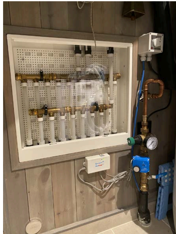
Vannfordelskap. Hovedvanninntak med stoppekran.
