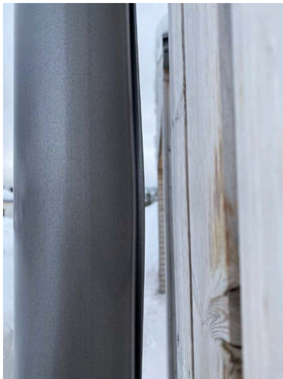
Nedløp med frostpreng.
