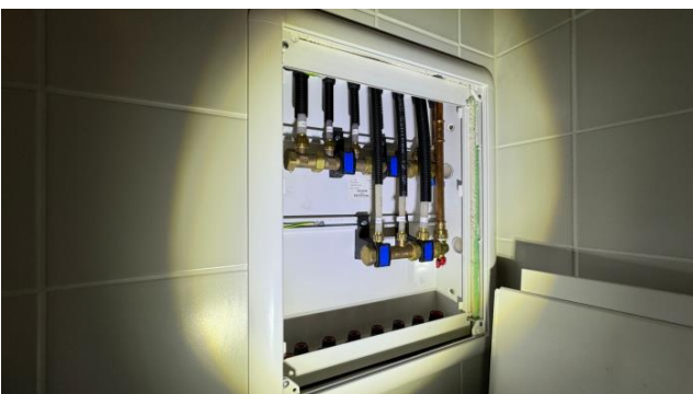
Kontroll av rørfordelerskap.
