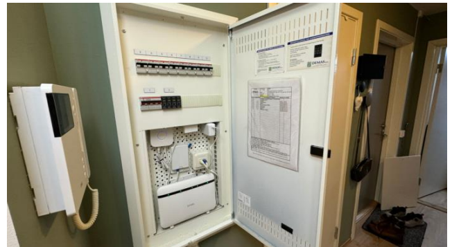
Kontroll av el-skap og kursfortegnelse.
