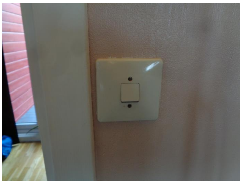
Noe eldre el-anlegg.
