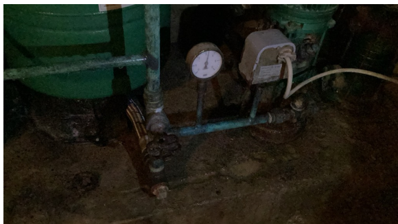
Stoppekran i kjeller.
