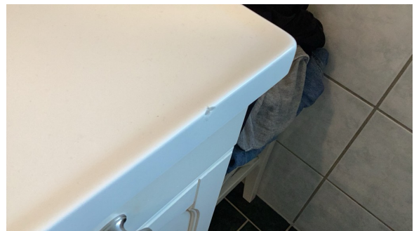
Skade på servant.
