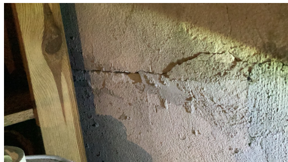
Horisontal sprekk med forskyvning.
