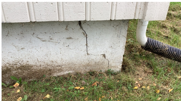
Eksempel på sprekk i grunnmur.
