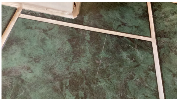
Eksempel på sprekk i gulv.
