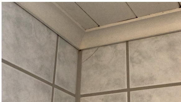
Eksempel på sprekk i flis.
