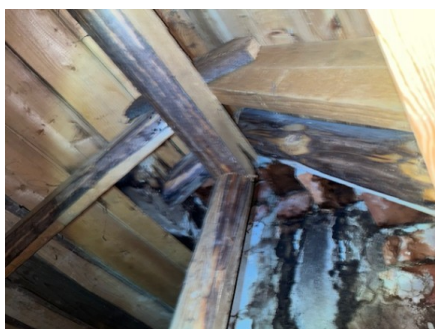
Fuktmerker ved pipe.
