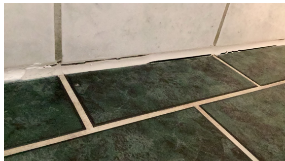
Det sprekker opp mellom gulv og vegg
