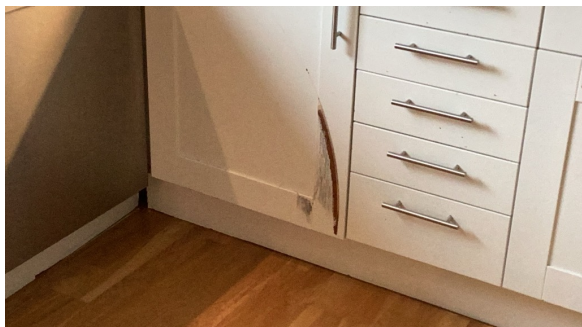
Eksempel på slitasje.
