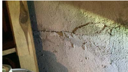
Horisontal sprekk med forskyvning.
