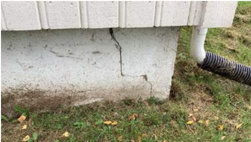
Eksempel på sprekk i grunnmur.
