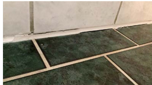
Det sprekker opp mellom gulv og vegg
