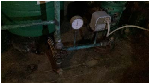
Stoppekran i kjeller.
