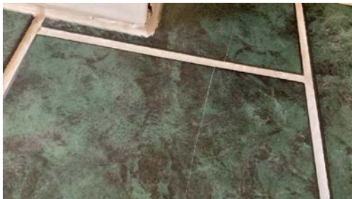
Eksempel på sprekk i gulv.
