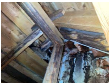
Fuktmerker ved pipe.
