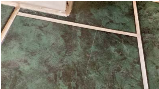
Eksempel på sprekk i gulv.
