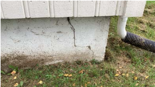
Eksempel på sprekk i grunnmur.
