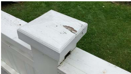
Eksempel på slitasje/misfarging.
