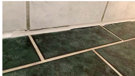
Det sprekker opp mellom gulv og vegg
