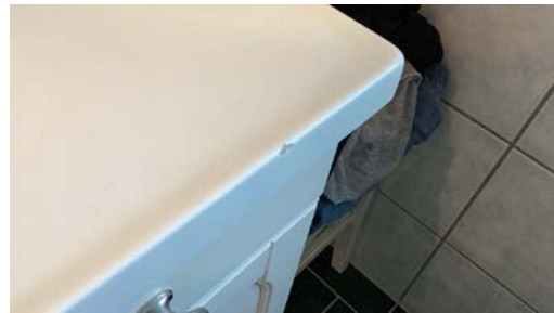
Skade på servant.
