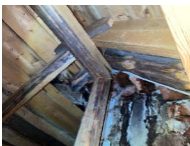
Fuktmerker ved pipe.
