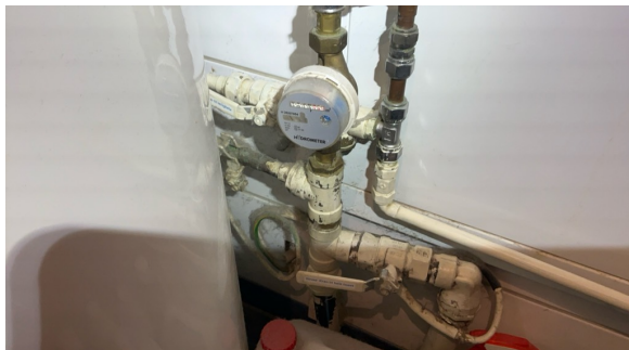
Hovedstoppekran og vannmåler på bad.
