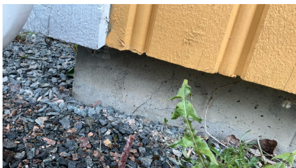
Sprekker/riss i grunnmur registrert.
