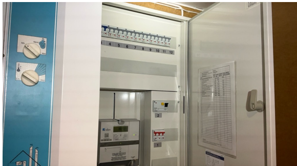
Sikringsskap plassert i bod.
