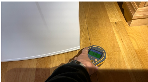
Sprekk/svelling på kjøkkengulv. Fuktsøk viste tørre verdier.
