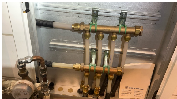
Fordelerskap på bad.
