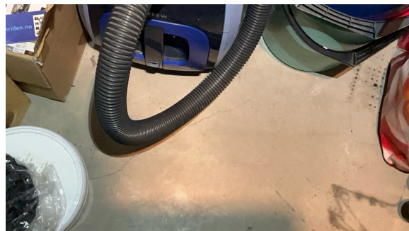
Sprekker i betonggulv.
