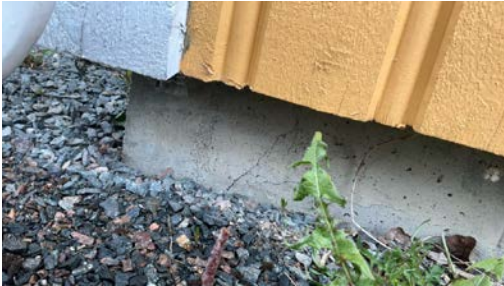
Sprekker/riss i grunnmur registrert.
