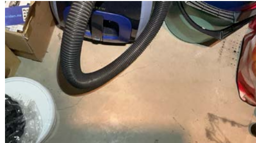
Sprekker i betonggulv.
