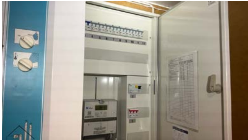
Sikringsskap plassert i bod.
