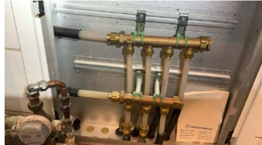
Fordelerskap på bad.
