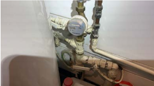
Hovedstoppekran og vannmåler på bad.
