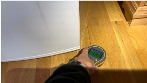
Sprekk/svelling på kjøkkengulv. Fuktspøk viste tørre verdier.
