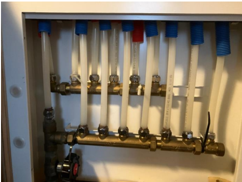
Fordelerskap for rør i rør til hovedetasje, montert på vaskerom:
