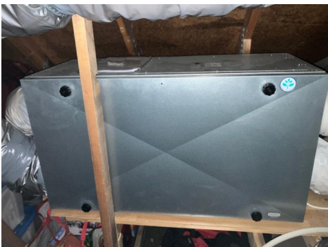
Mekansik avtrekk, montert på loft
