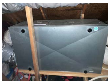
Mekanisk avtrekk, montert på loft
