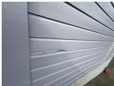
Kledningsbord som må byttes ut.
